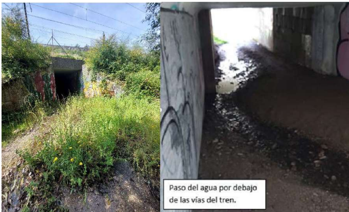
Imagen 12. Drenaje bajo vías de tren. Existe una acción para acondicionar el drenaje y se debe tener en cuenta incorporar un paso para fauna longitudinal en uno de los laterales.
