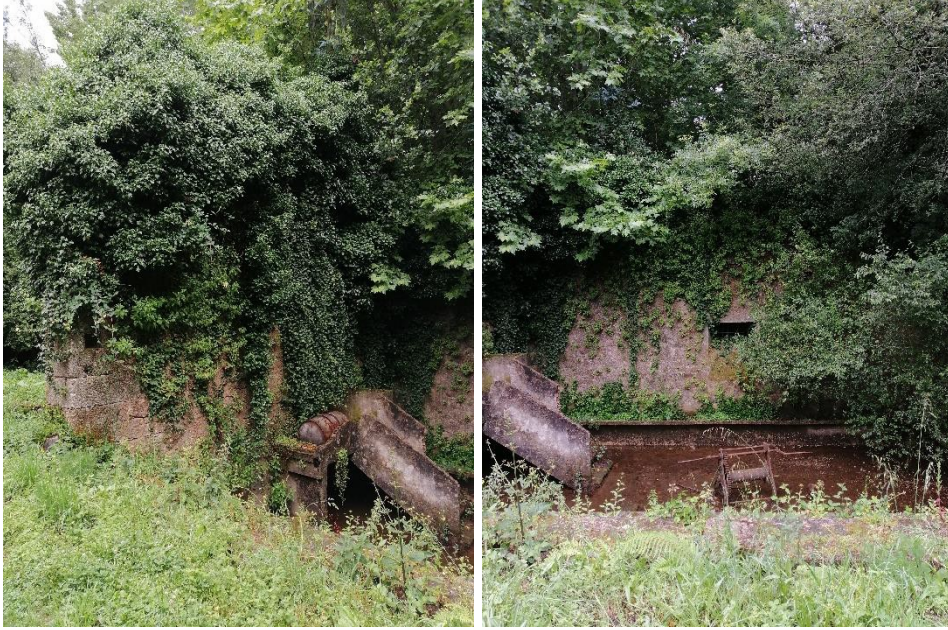
Imagen 14. Edificio de antiguo lavadero ideal para la instalación de cajas nido para murciélagos y rapaces nocturnas.
